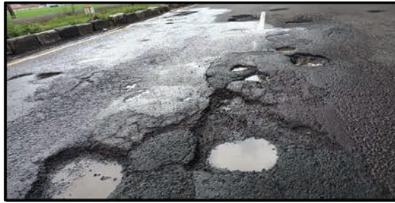
Permukaan jalan yang rosak boleh menyebabkan kemalangan dan merosakkan kenderaan.
